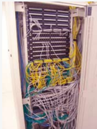
1 gigabit per sekunds ISCSI (gröna UTP) kopplas som vanligt med CAT5-kabel. Fibrerna från lagringsserverna kommer in längst ned.
